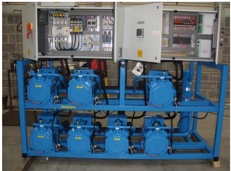
Система централизованного холодоснабжения: Компрессорная станция подключена к многочисленным прилавкам-витринам супермаркета и к отдельно установленному конденсатору
